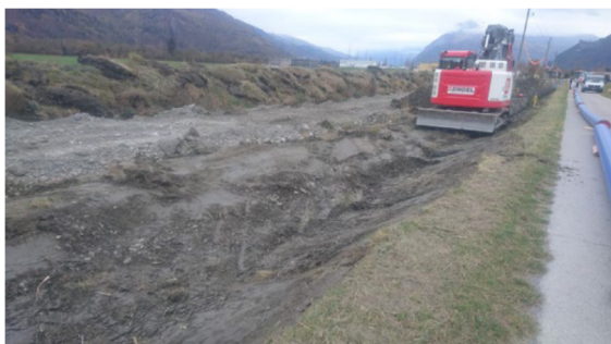
Der Oberboden aus dem alten Bewässerungskanal wurde bereits abgetragen und auf dem Humusdepot zwischengelagert. Im zweiten Schritt wird der BC-Horizont abgetragen und der Graben für das Verlegen der Rohre vorbereitet
